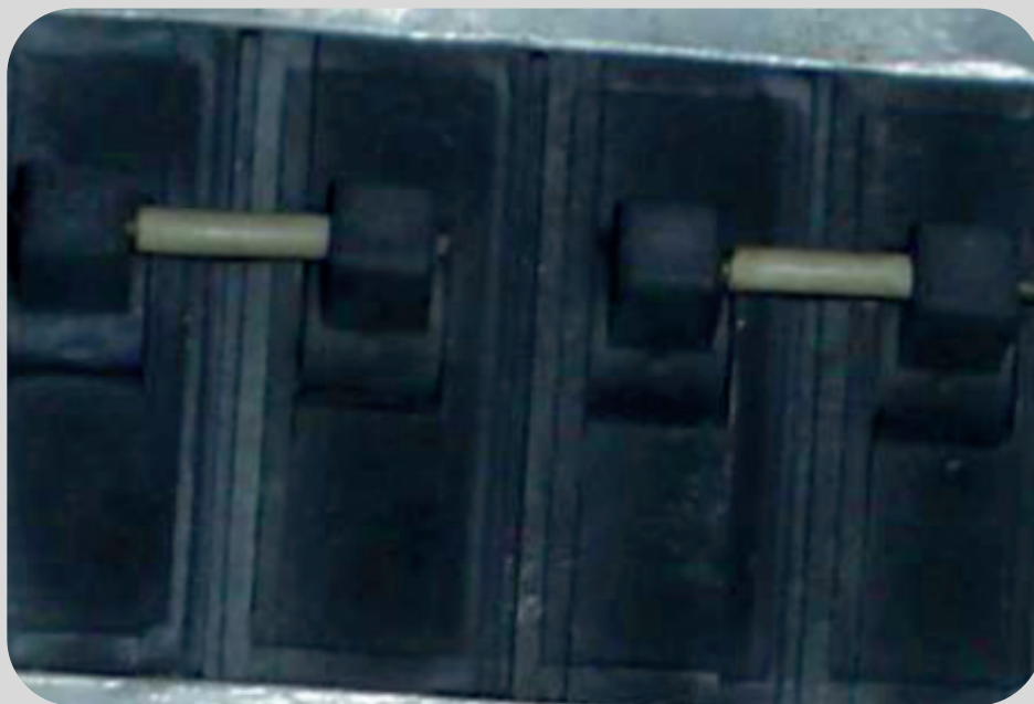
Imagem 5 – Disjuntor monopolar em circuito Bipolar - Escola
