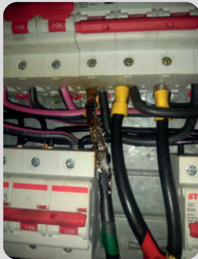
Imagem 2 Quadro de distribuição de uma autarquia
