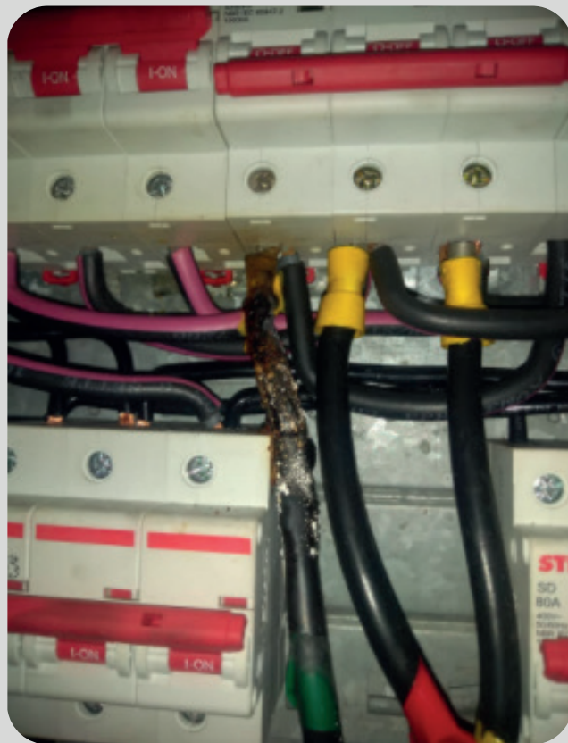
Imagem 2 Quadro de distribuição de uma autarquia
